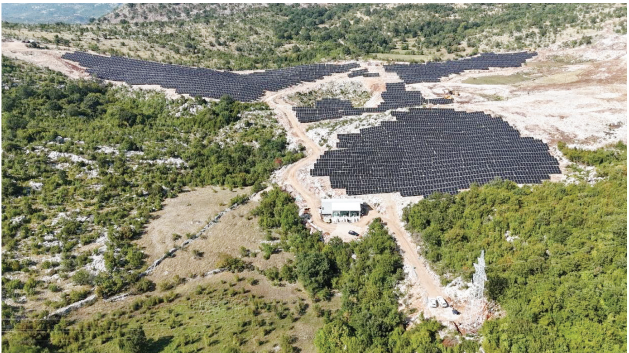
Slika 9: Solarna elektrana ukupne instalisane snage 6.17 MWp odnosno 5 MW na AC strani sa završenim radovima
