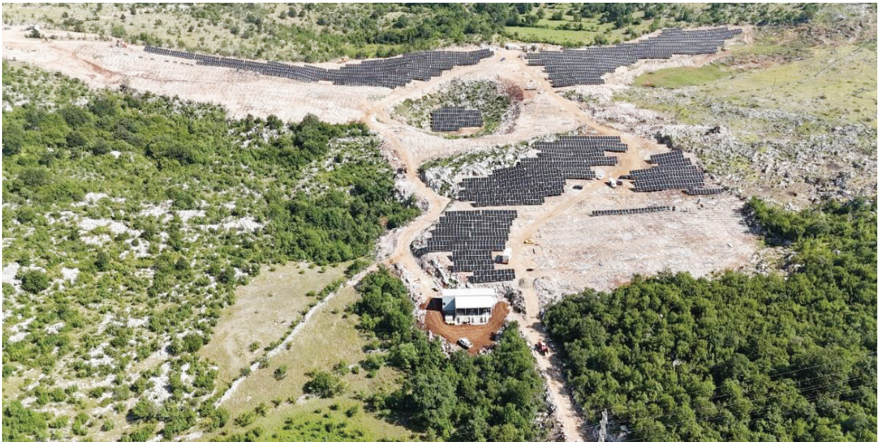
Slika 8: Zahvat solarne elektrane nakon ugrađenog većeg dijela solarnih panela, izgrađene trafostanice i sa zamijenjenim stubom u tački priključenja
