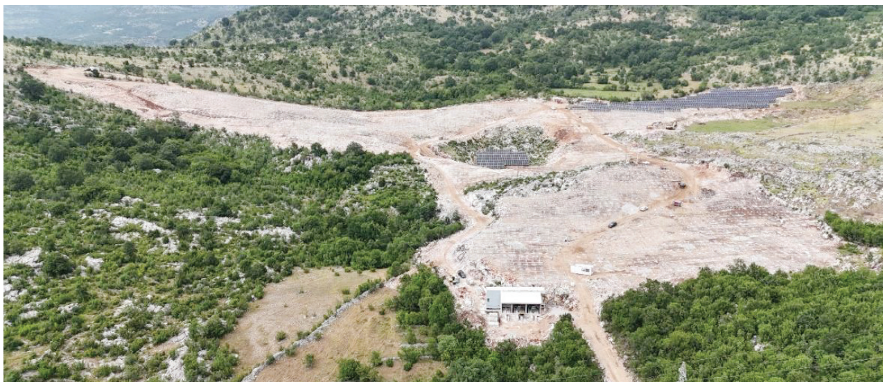
Slika 6: Zahvat solarne elektrane nakon postavljanja čelične konstrukcije, postavljenih djelova solarnih panela i izgrađenih grubih građevinskih radova proizvodne trafostanice
