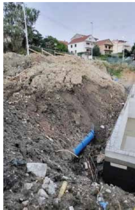
Izgled lokacije sa zatrpanim cjevovodom od pokrenute zemlje, foto: O. Doklešić
