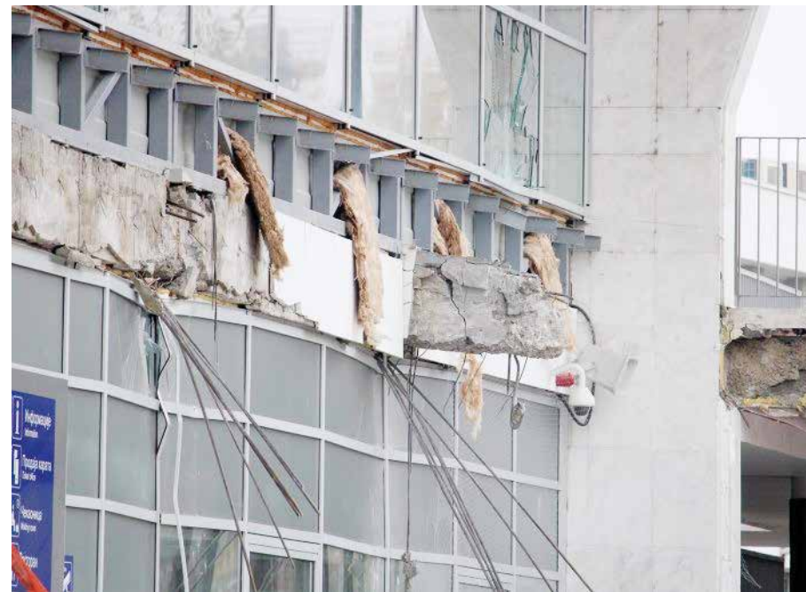
Željeznička stanica u Novom Sadu nakon pada nadstrešnice, foto: Dr Goran V. Anđelković
