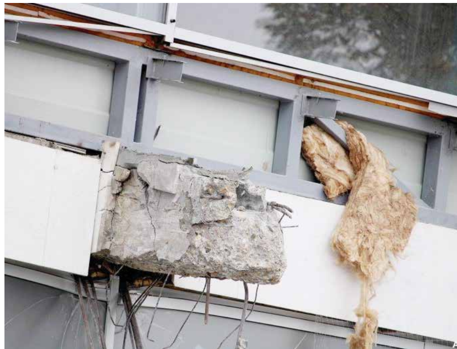
Željeznička stanica u Novom Sadu nakon pada nadstrešnice, foto: Dr Goran V. Anđelković
