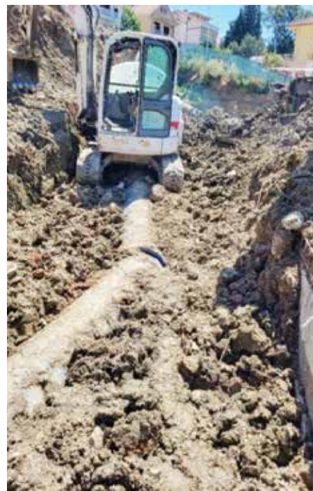
Izgled cjevovoda nakon uklanjanja nadsloja zemlje sa poremećenom trasom, foto: O. Doklešić
