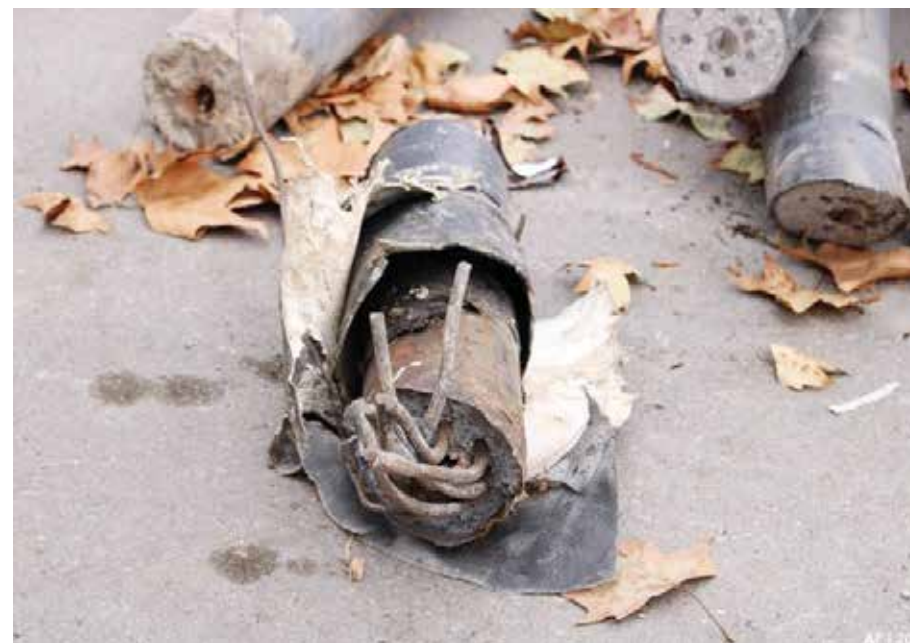
Detalj zatege na Željezničkoj stanici u Novom Sadu nakon pada nadstrešnice, foto: Dr Goran V. Anđelković
