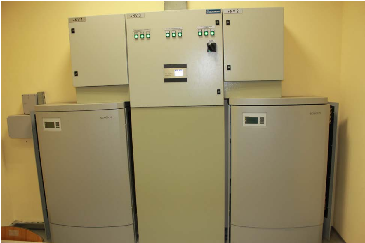
Fotografija broj 15 Izgled Razvodnih ormara za DC i AC opremu i Invertore solarne elektrane snage 55 kW pika
