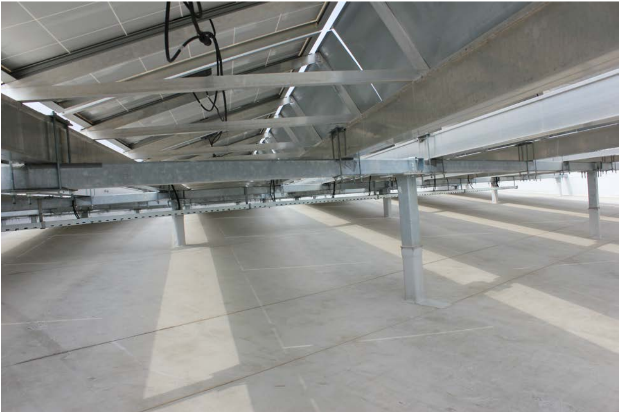
Fotografija broj 14 Izgled krova sa krovnim pokrivačem od sike sa podkonstrukcijom koja nosi solarne panele na celoj površini krova krovu
