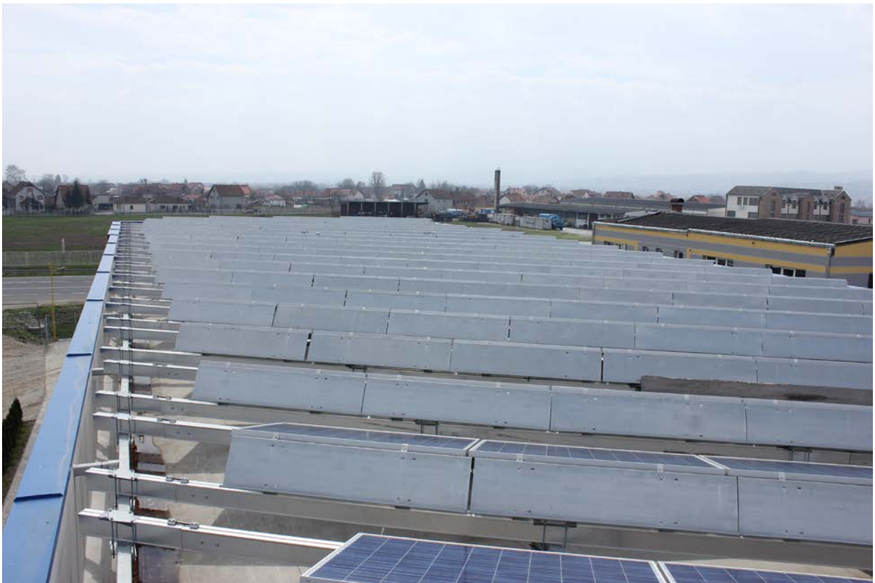
Fotografija broj 13 Izgled krova sa solarnim panelima na celoj površini krova snage 55 kWpika
