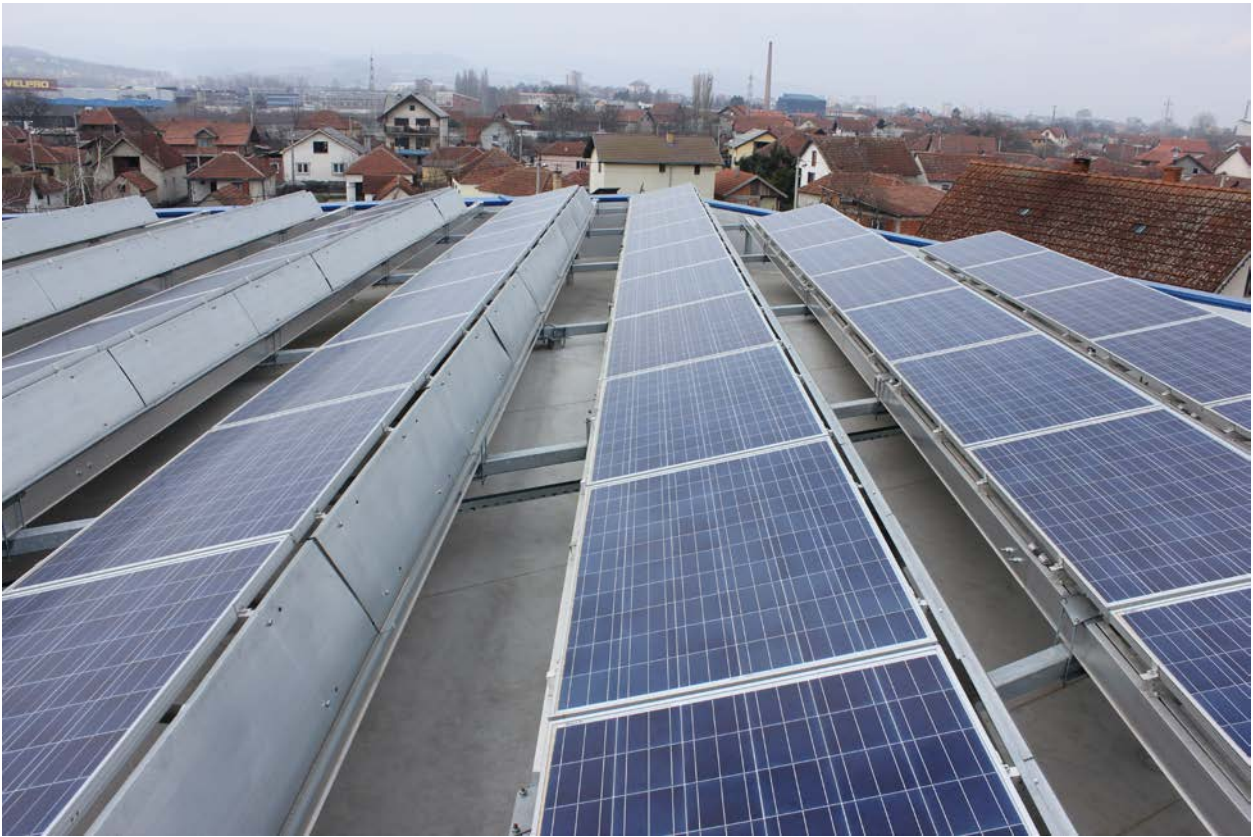
Fotografija broj 12 Izgled krova sa solarnim panelima
