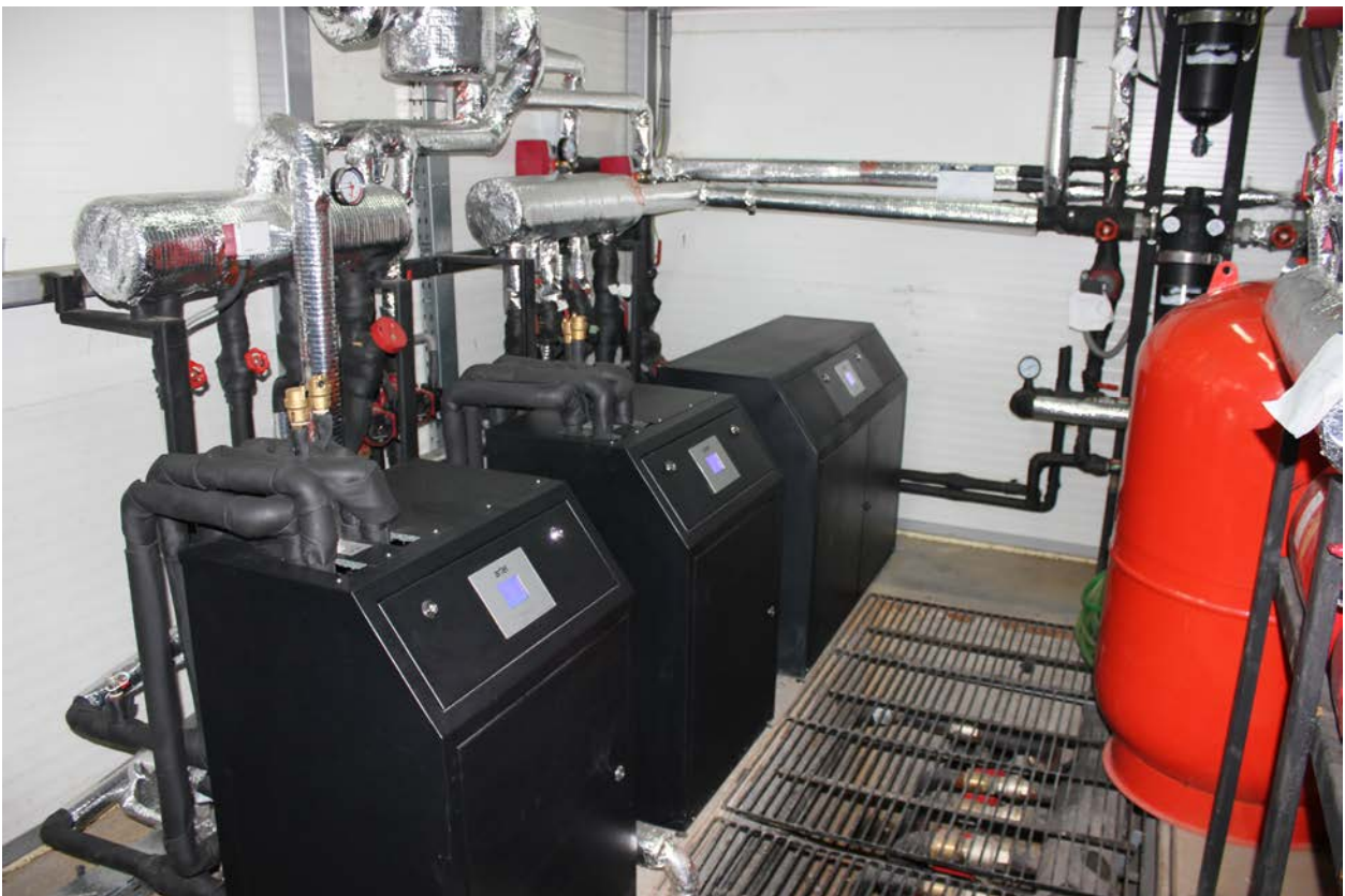
Fotografija broj 14 Izgled tri toplotne pumpe voda -voda u energani
