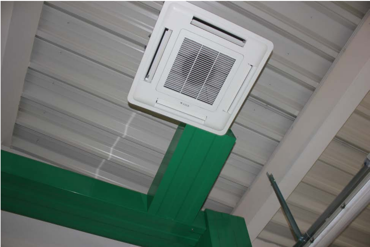
Fotografija broj 8 Izgled plafonskog fan-coil uređaja koji služi za grejanje i hlađenje proizvodnog dela ako podno grejanje ne postigne temperaturu koja je setovana
