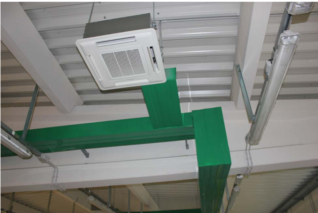
Fotografija broj 9 Izgled plafonskog fan-coil uređaja koji služi za grejanje i hlađenje proizvodnog dela ako podno grejanje ne postigne temperaturu koja je setovana .
