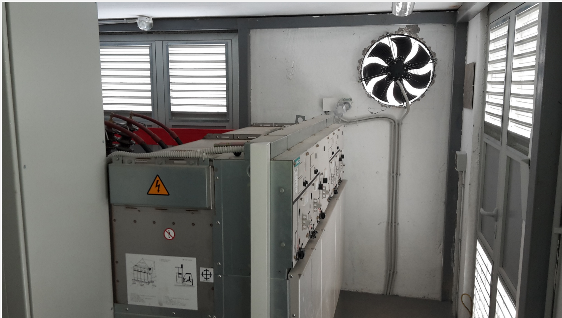
Slika 7 – Unutrašnjost portalne transformatorske stanice
