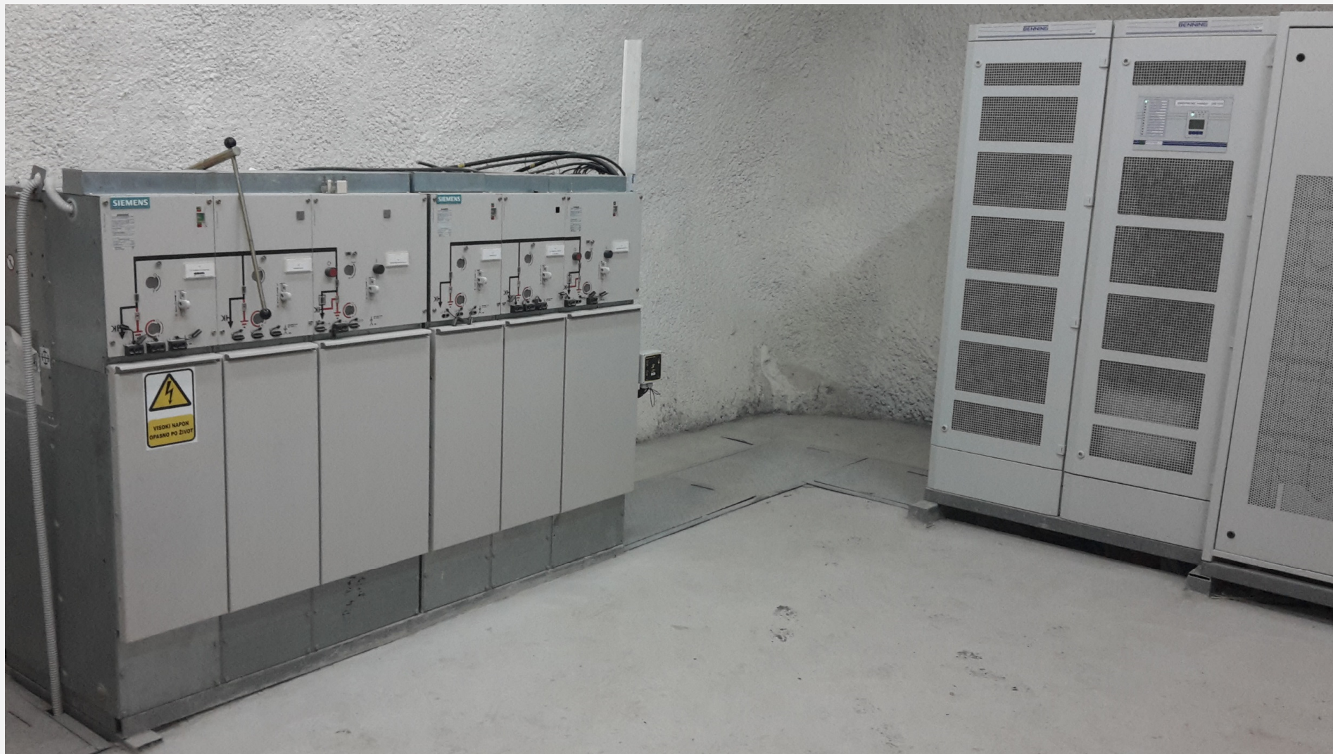
Slika 12 – Unutrašnjost transformatorske stanice u zaustavnoj niši
