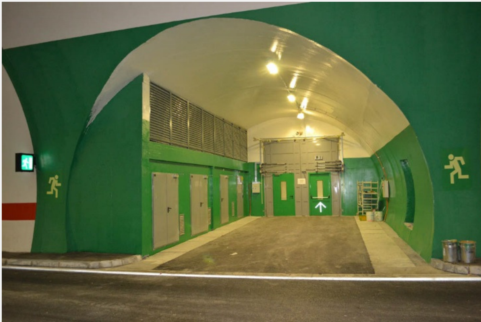
Slika 9 – Izgled tunelske transformatorske stanice u prolazu za vozila
