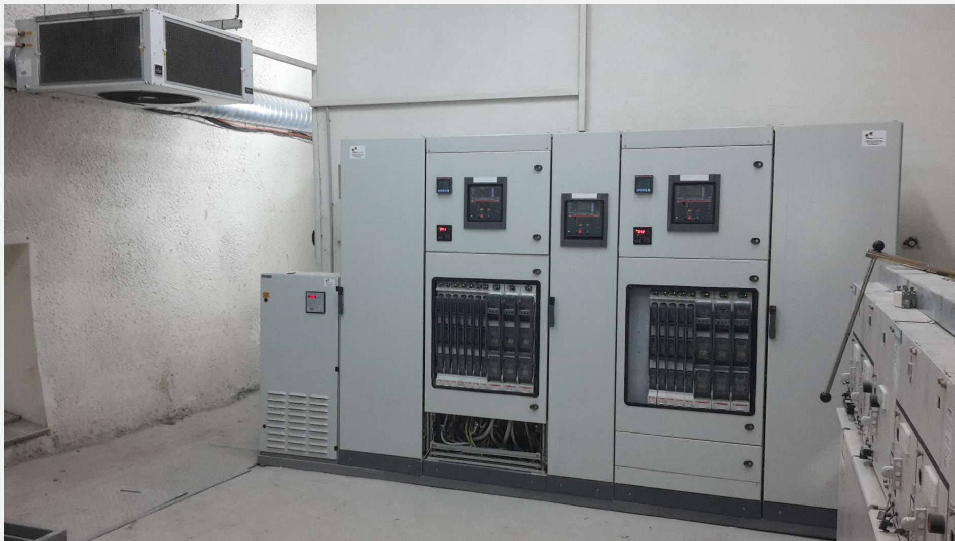
Slika 11 – Unutrašnjost transformatorske stanice u zaustavnoj niši
