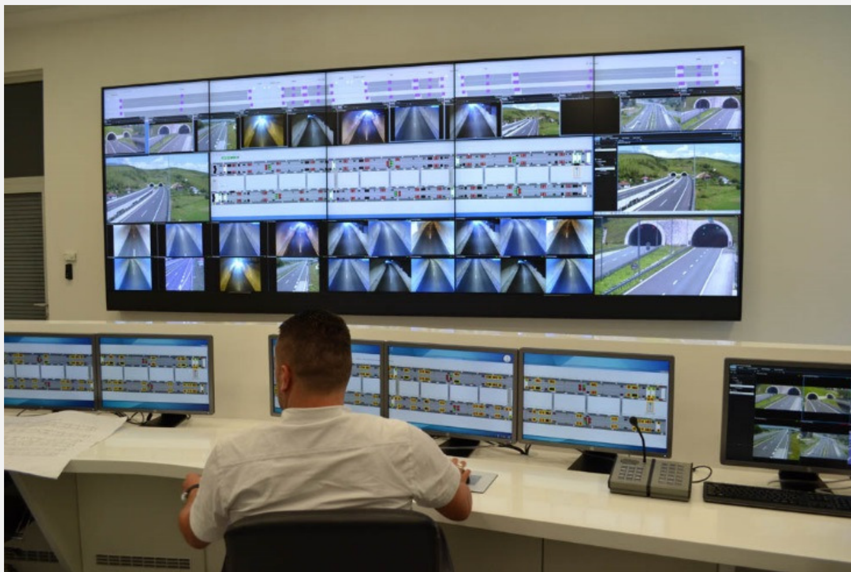
Slika 32 – Centar za održavanje i kontrolu prometa (COKP)
