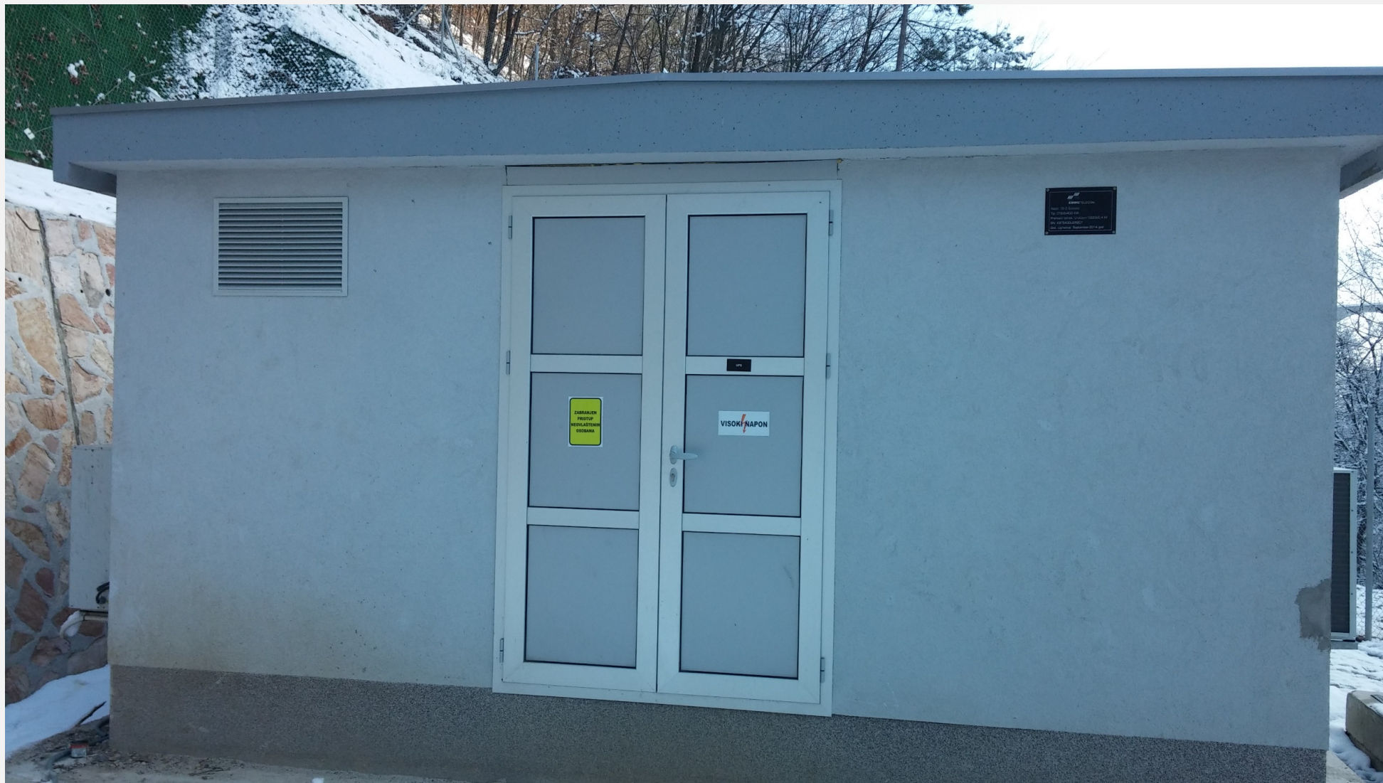
Slika 6 – Izgled portalne transformatorske stanice
