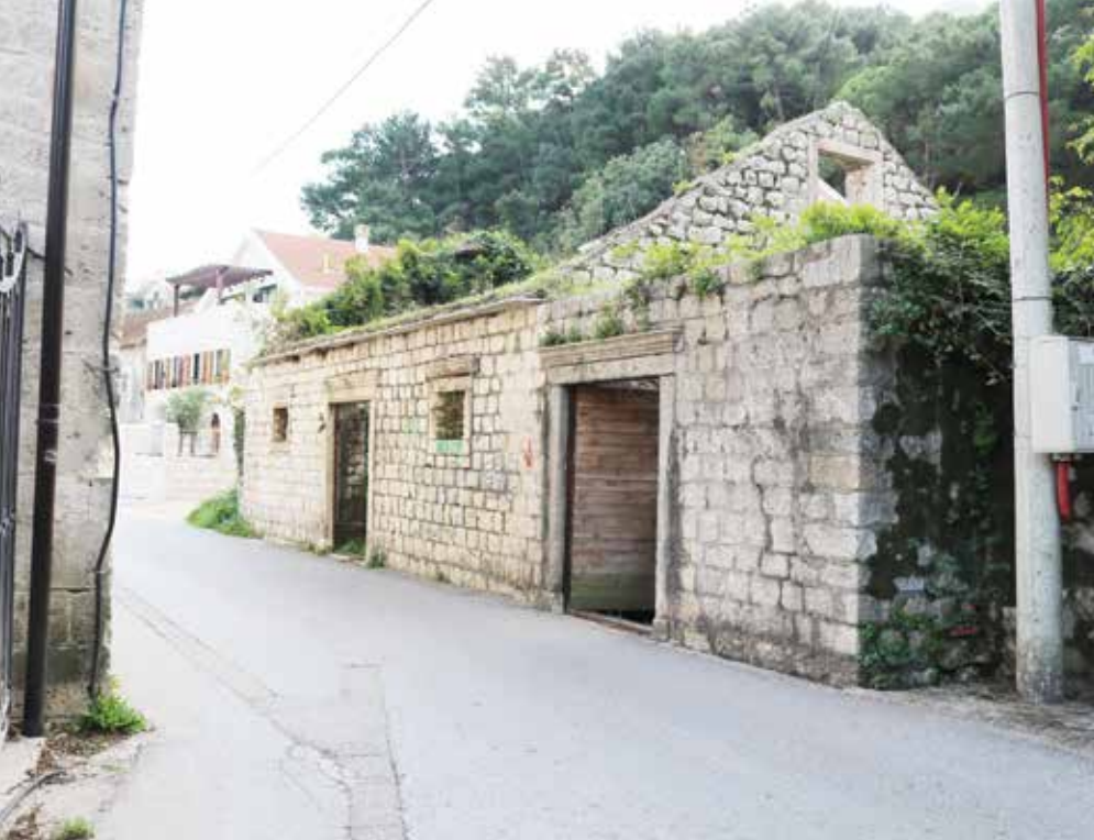
Devastirana tradicionalna kuća, lokacija Prčanj, foto: Aldijana Hodžić
