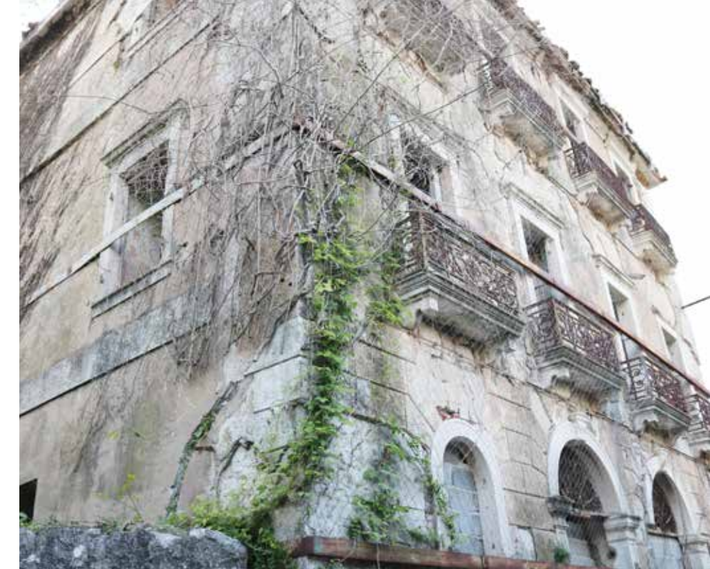
Devastirana tradicionalna kuća, lokacija Prčanj, foto: Aldijana Hodžić
