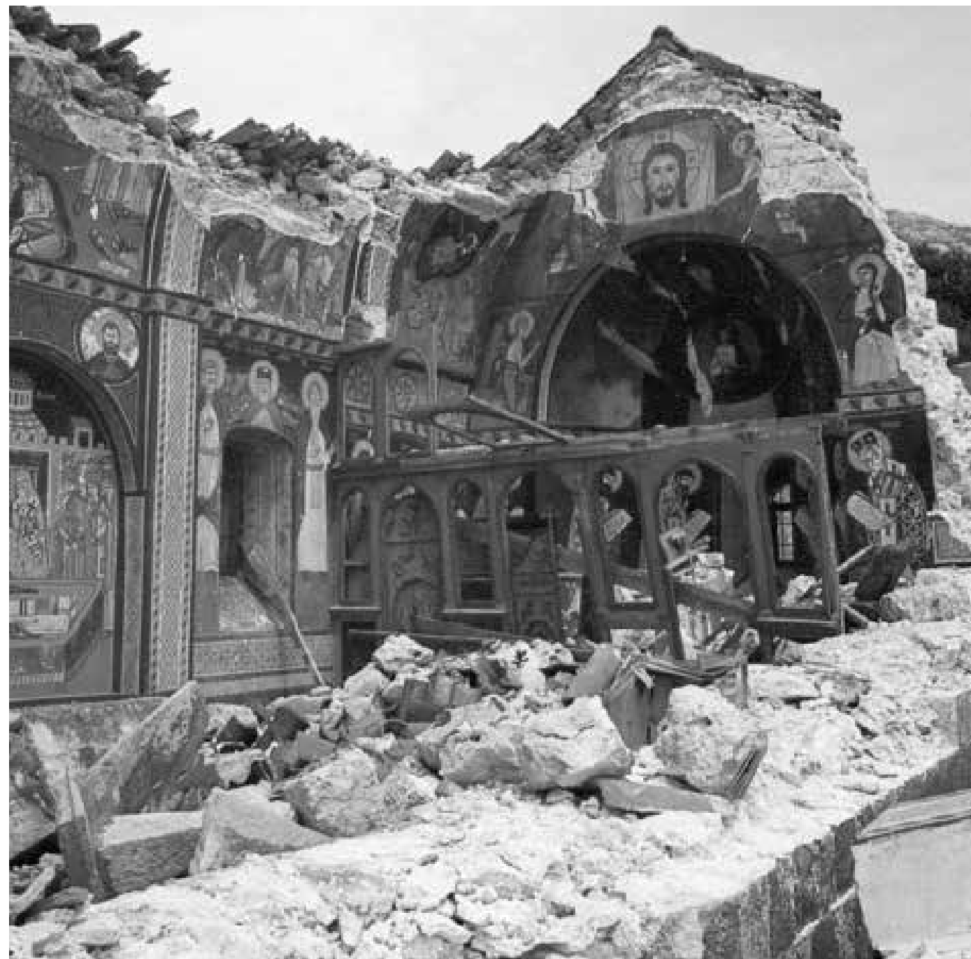
Manastir Gradište, Buljarica, nakon zemljotresa 1979. Godine, foto: Privatna arhiva
